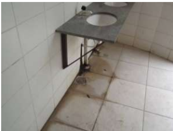
Fotografia 3 - Exemplo de sujeira nos banheiros
