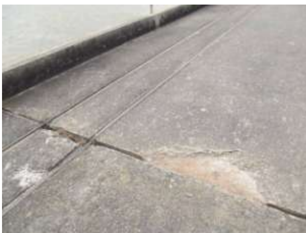
Fotografia 4 - Deterioração do trapiche
