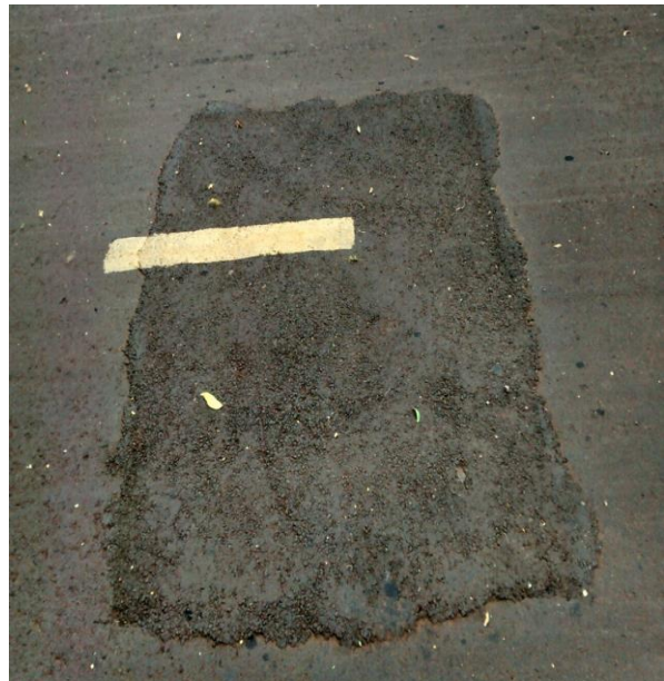
Figura 7 – Remendo mal executado na Rua Pastor Albert Lembauer – Centro – Santa Rosa/RS
