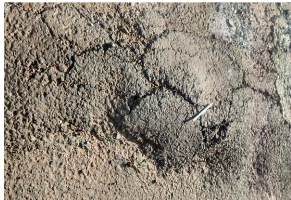
Figura 5 – Afundamento por consolidação localizada na rua General Rondon – Centro – Santa Rosa/RS
