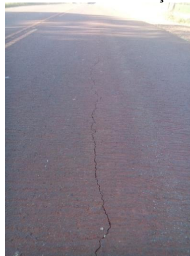
Figura 1 - Trinca Longitudinal Longa no trecho RS 305 entre Tuparendi e Tucunduva/RS
