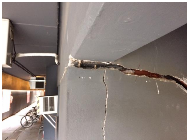
Figura 4. Patologia no prédio vizinho ao edifício público
