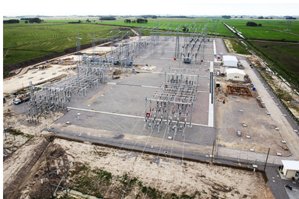
Figura 4. Obra da Subestação Santa Vitória do Palmar A,B - 500/138 KV - Eletrosul (SCHREIBER ENGENHARIA, 2016)
