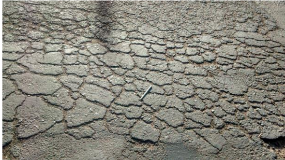
Figura 4 – Trincas tipo couro de jacaré na Rua General Rondon – Centro – Santa Rosa/RS
