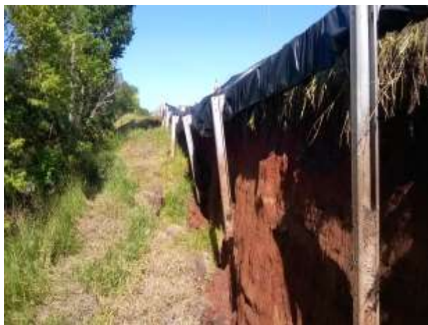
Figura 7. Ruptura do talude do km 76 da BR-290/RS
