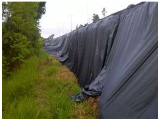
Figura 9. Vista do talude no km 76 da BR-290/RS – Proteção com lonas plásticas (impermeabilização)
