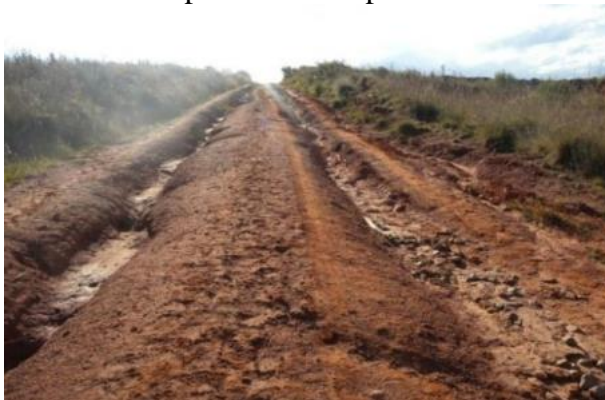
Figura 1 – Erosão no solo do CISM (MALLMANN, 2012).
