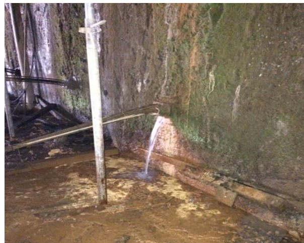
Figura 3. Fluxo de água pelo tirante no prédio público
